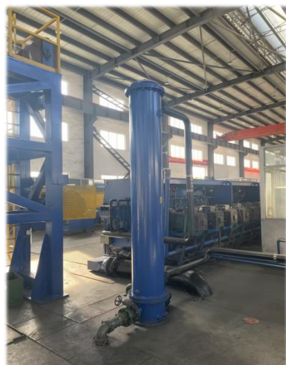
换热器更新换代 (降低油温，提高拉丝油使用寿命)
